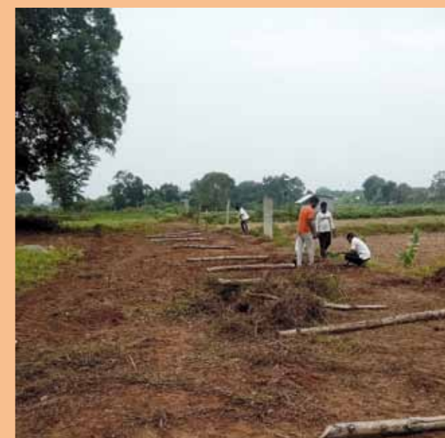
Landumzäunung zum Schutz des Trinkwassers
