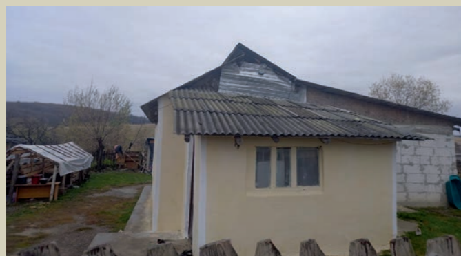
Asbest-Dach rinnt – wer hilft?
